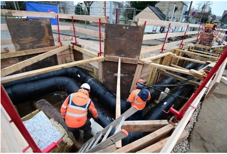
Les travaux d'extension du réseau de chaleur, au Mans. © Le Mans Métropole
