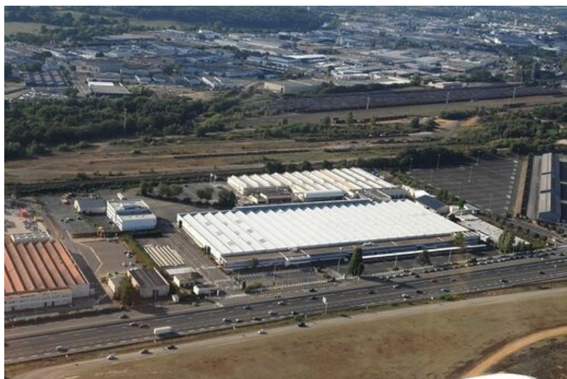
À Actisud, ancien site Phillips, la démolition partielle du bâtiment principal a été engagée en 2017. © Ville du Mans
